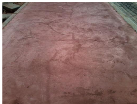
FIGURA 02 – Imagem evidenciando a presença de fissuras no pavimento da ciclovia.
