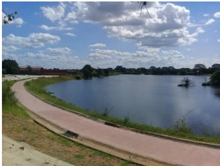
(a) Trecho antes demolido não apresentou mais fissuras aparentes, após adição das fibras.
