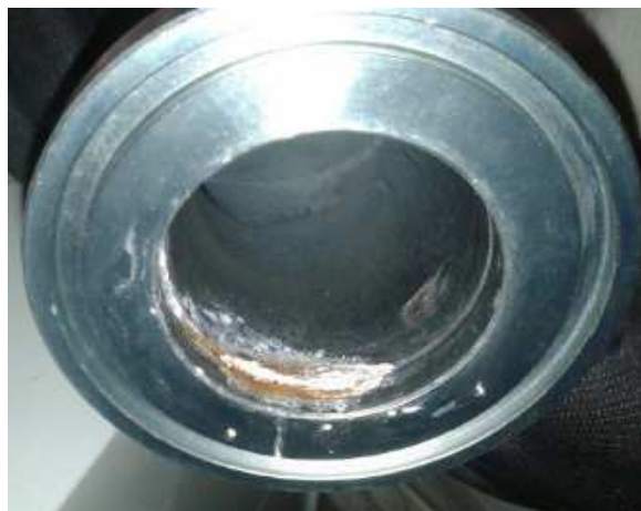
Figura 3 - Oxidação interna do componente
