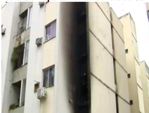
Figura 5–Incêndio em apartamento na Praia do Canto (Vitória, ES).
