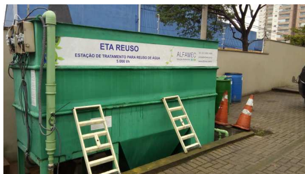
Figura 1 – Eta – Estação de tratamento de água (reúso) adquirida para tratamento dos efluentes oleosos e com abrasivos provenientes do uso nas atividades da concessionária Cardinal.
